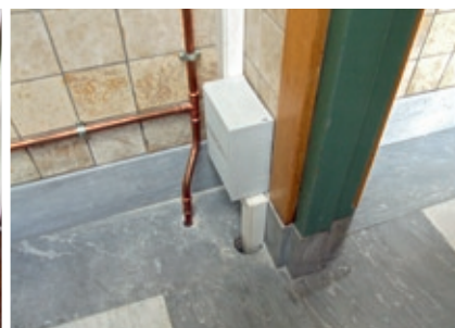
Leidingen gaan hier door een originele marmeren vloer.
