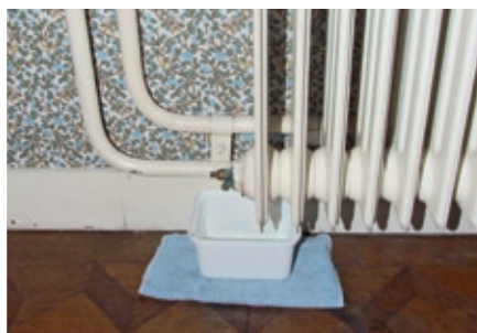
Een lekkende radiator brengt schade toe aan een parketvloer.
